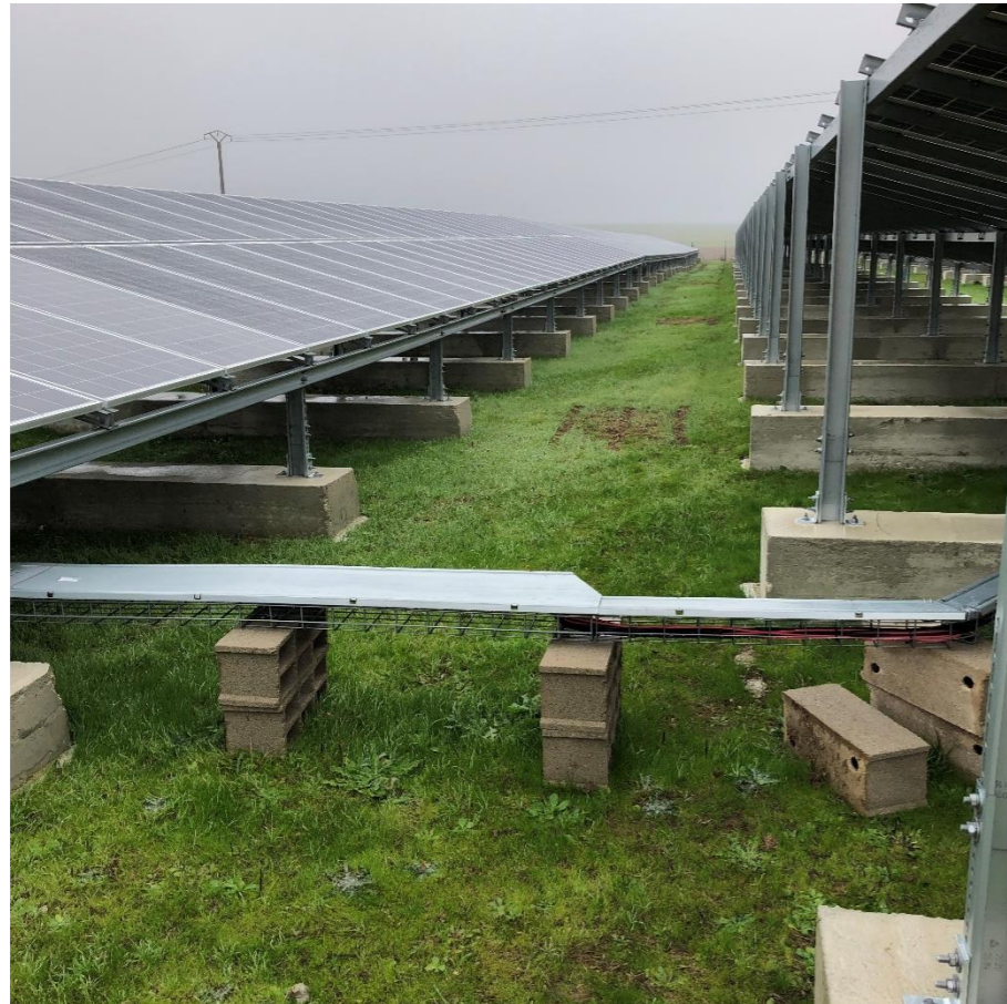
Exemples de câblages hors sol non intrusif
