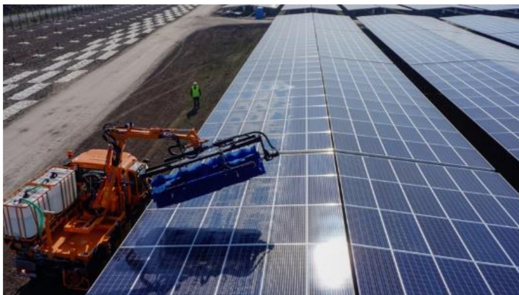
Illustration 64: Exemple de procédé de nettoyage des modules (Neoen)
