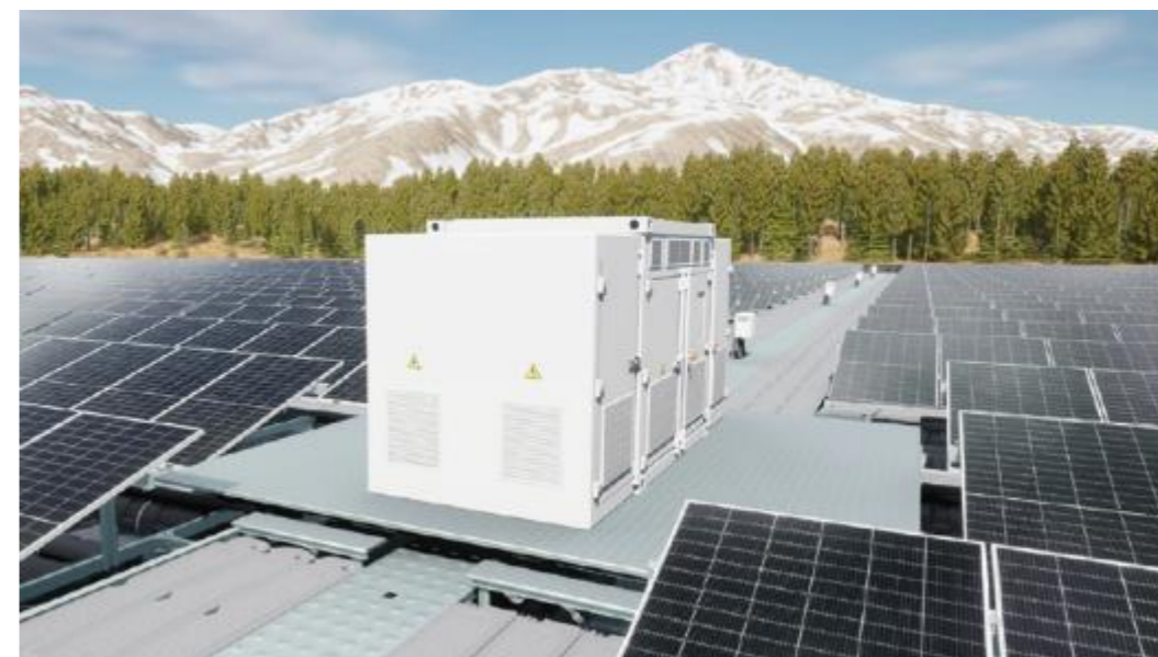
Illustration 44: Transformateur sur flotteur (Neoen)
