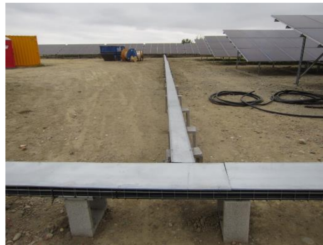
Illustration 27: Exemple de câblage hors sol sur chemin de câble (Neoen)
