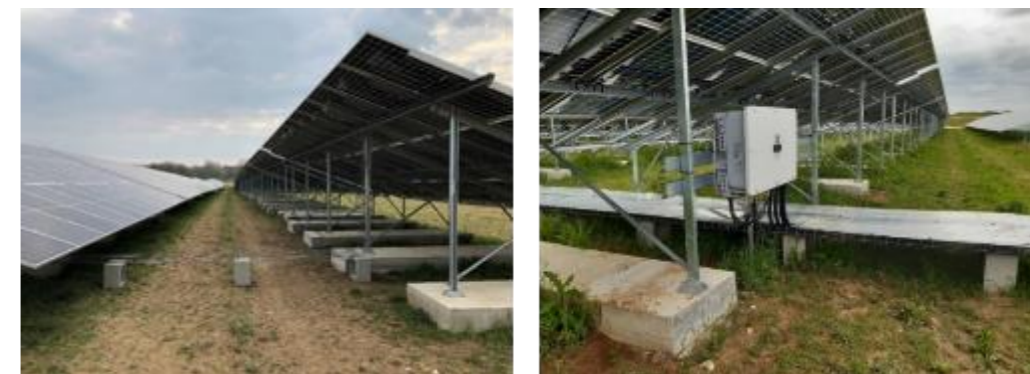
Illustration 58: Exemples de câblages hors sol non intrusif (Neoen)
