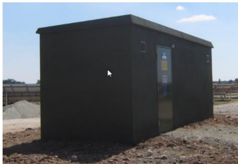
Illustration 28: Exemple de poste de transformation « indoor » (Neoen)
