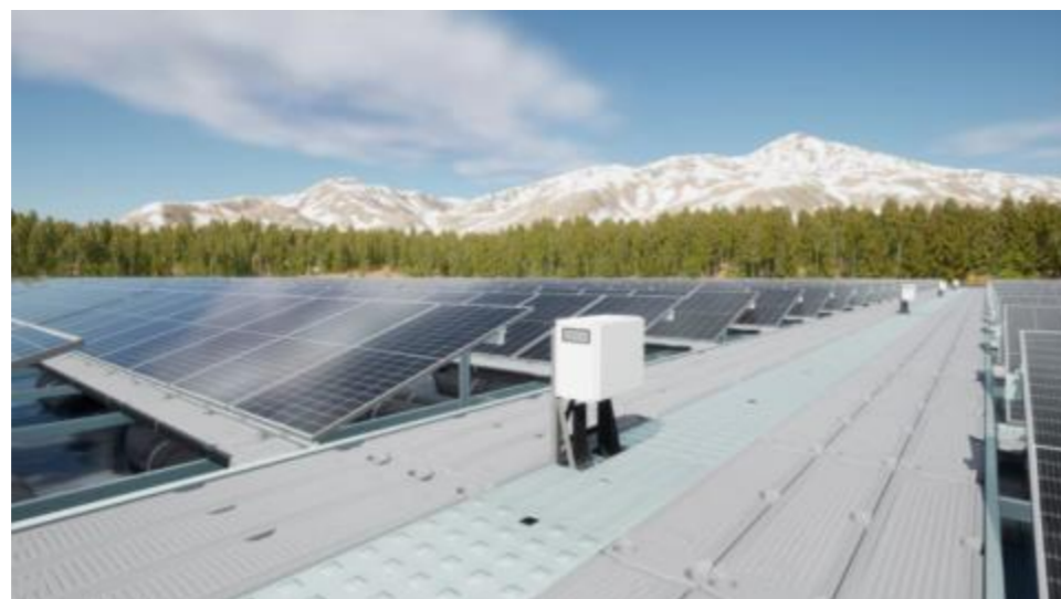
Illustration 42: Onduleur décentralisé sur flotteur (Neoen)
