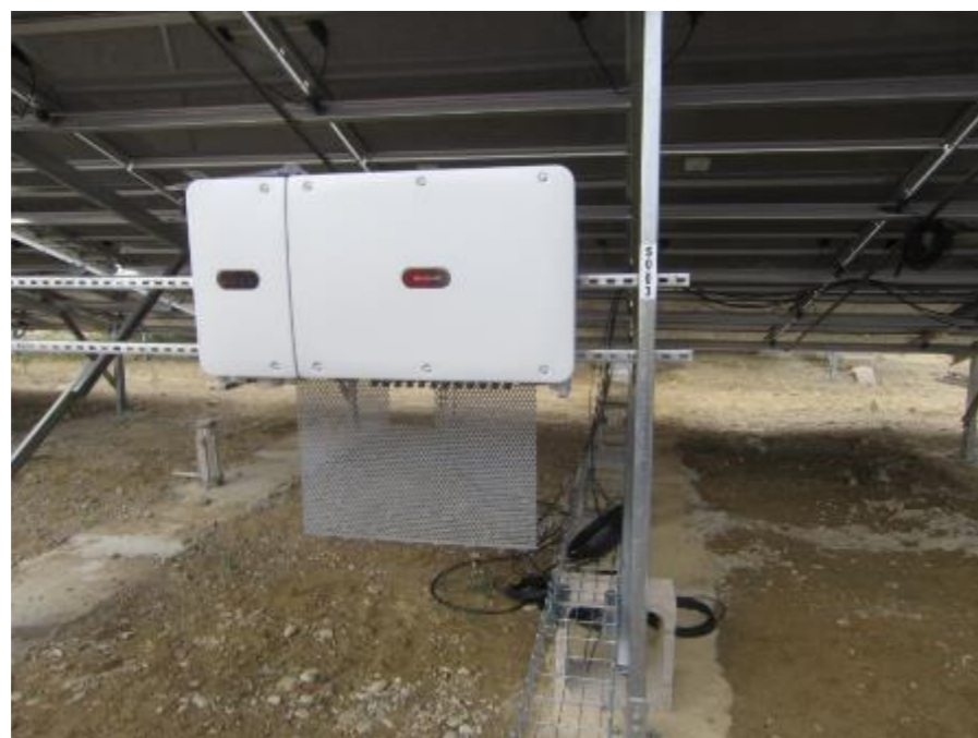
Illustration 29: Exemple d'onduleur décentralisé (Neoen)
